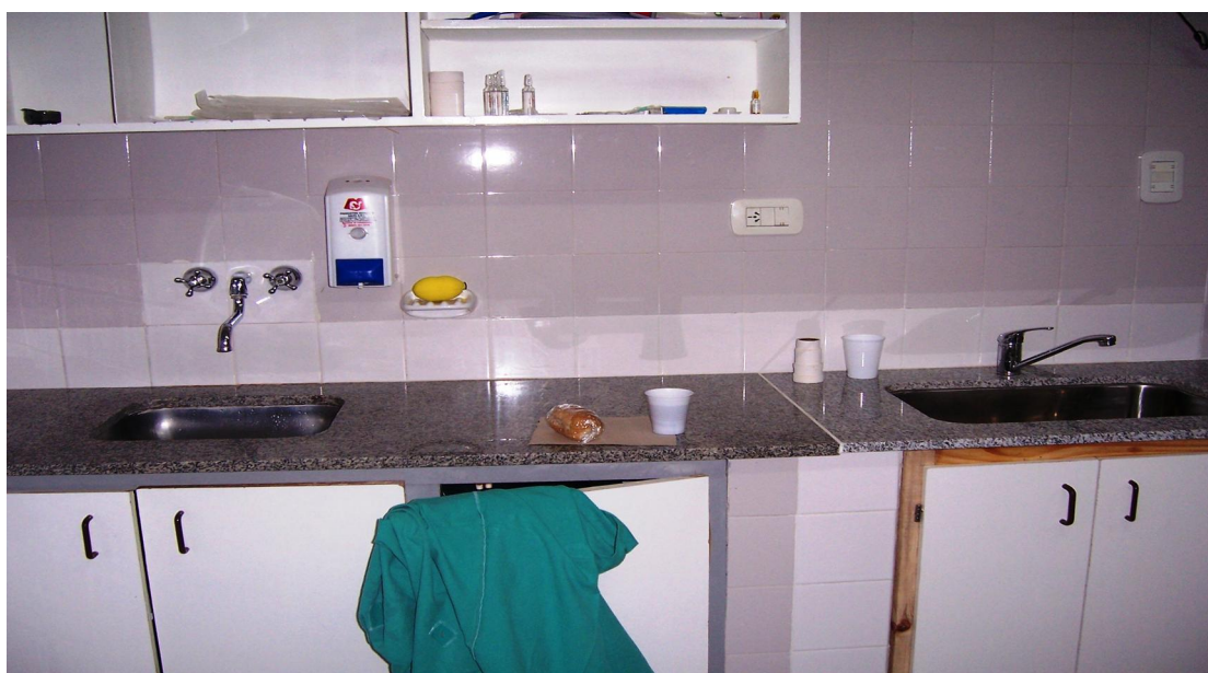
Puntos 1 y 2. Piletas para lavado de fistulas en sala de pacientes negativos y para lavado de artículos de limpieza
