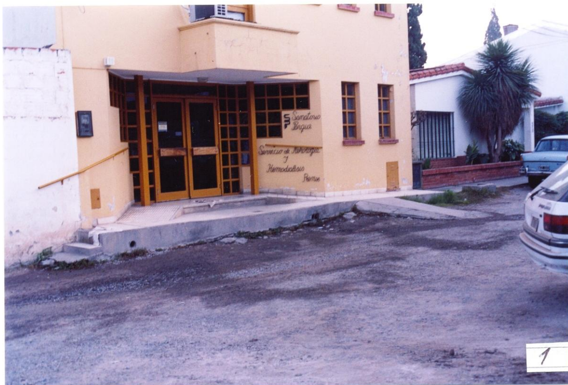
Fotografía N° 1 - Acceso al Centro de Diálisis RENNIUS S.A., del Sanatorio Parque – Rampa de acceso de longitud inadecuada.
