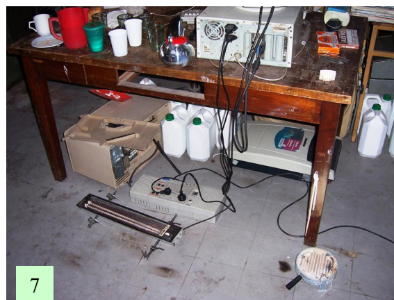
Archivo. Inadecuada conexión simultanea a tomacorriente múltiple (zapatilla)
