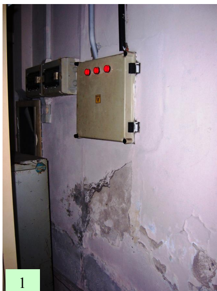
Deterioro de la capa aisladora horizontal
