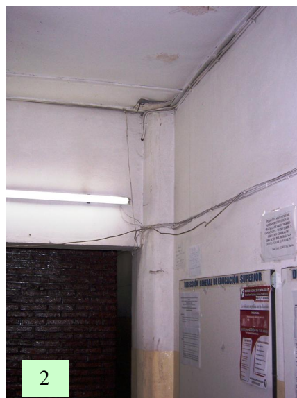
Sistema de cableado aéreo carente de en- vainado
