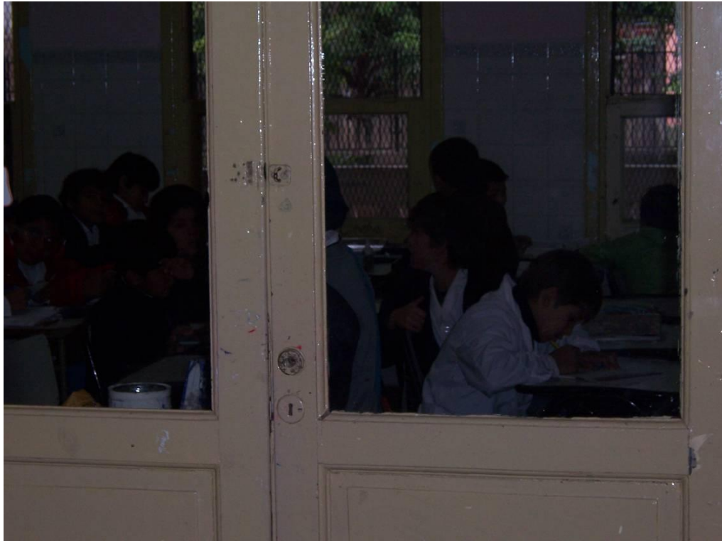
Fotografía N° 1: Rubro 7 – Carpintería – Herrería: Ajuste de carpintería y herrajes, no efectuadas.
