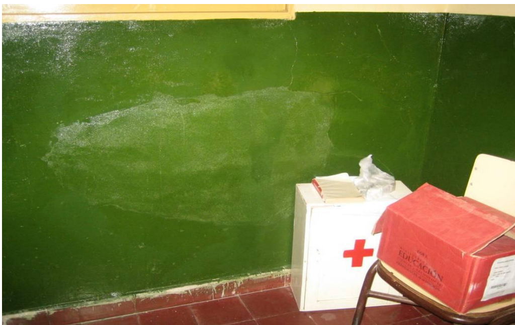
Foto N° 2 Ítem 2.01 "Revoques en General". Tareas ejecutadas: 0, 5 mts.2 - Previstas 20 mts.2
