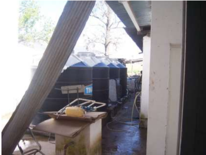
Tanques de agua de reserva
