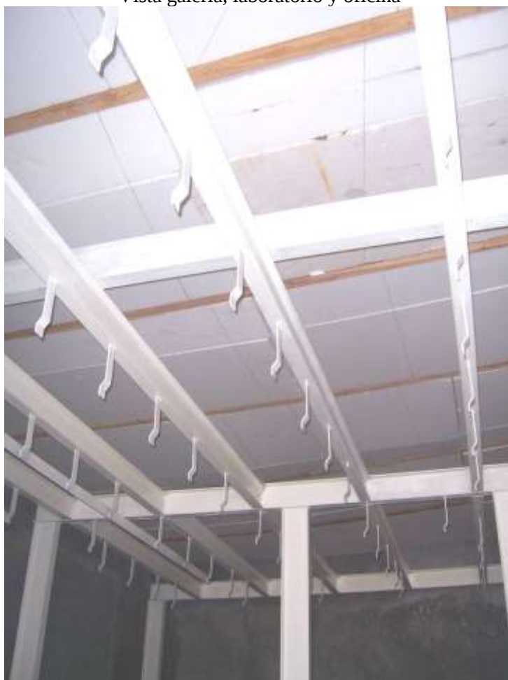
Rielera Cámara Frigorífica
