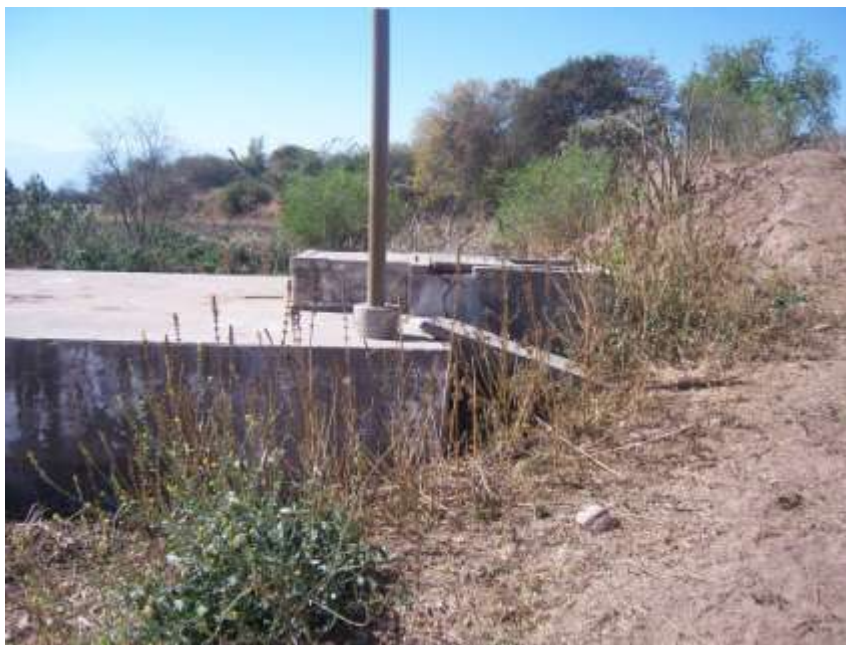
Cámara de inspección
