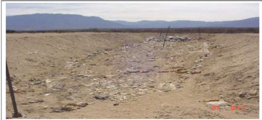
Aspecto de una trinchera en operación, se realizan labores de compactación y cobertura periódica. Los laterales están revestidos con PAD de alta densidad y recubiertos con material arcillo-arenoso para su protección.
