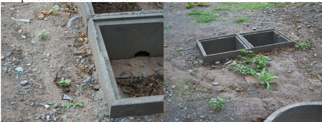
Observación 24 - Cámara de tratamiento lixiviado (falta compactación)
