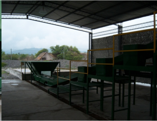
Tolva y Cinta transportadora
