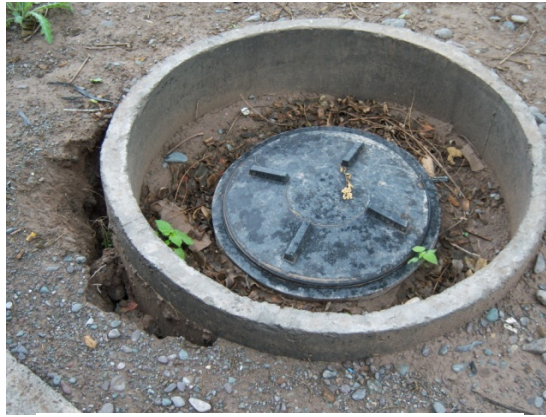
Depósito Lixiviado (falta compactac.)
