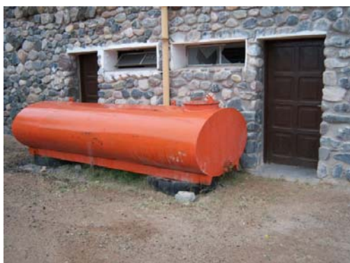
Tanque transporte de agua
