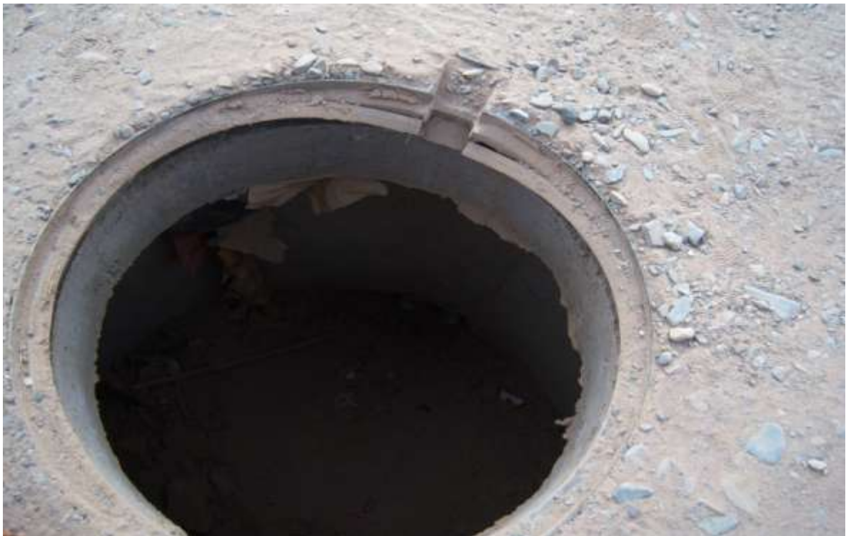
Boca registro Cloacal sin cojinete – Obstrucción del ducto
