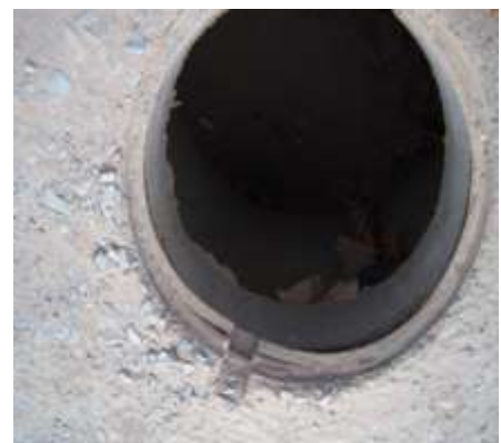
Boca registro cloacal
