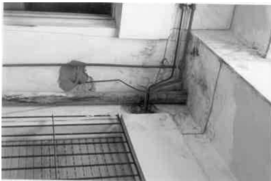
Hospital Materno Infantil. FHMI 1. Falta de mantenimiento correctivo en distintos sectores externos del Hospital.
