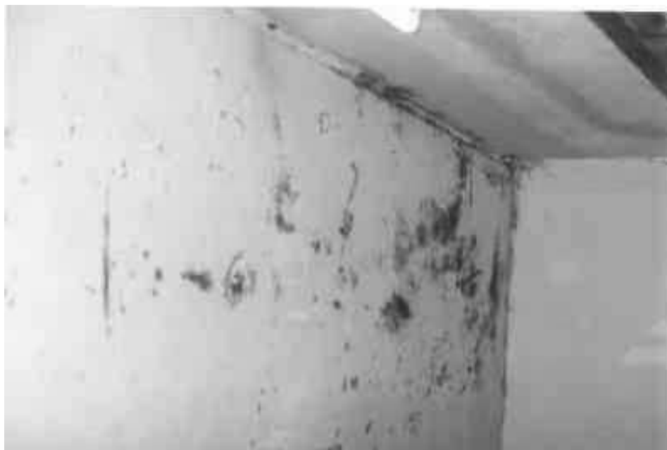
Hospital Dr. Miguel Ragone. FR 2 Sector Enfermería Internado Varones. Humedad y Hongos.
