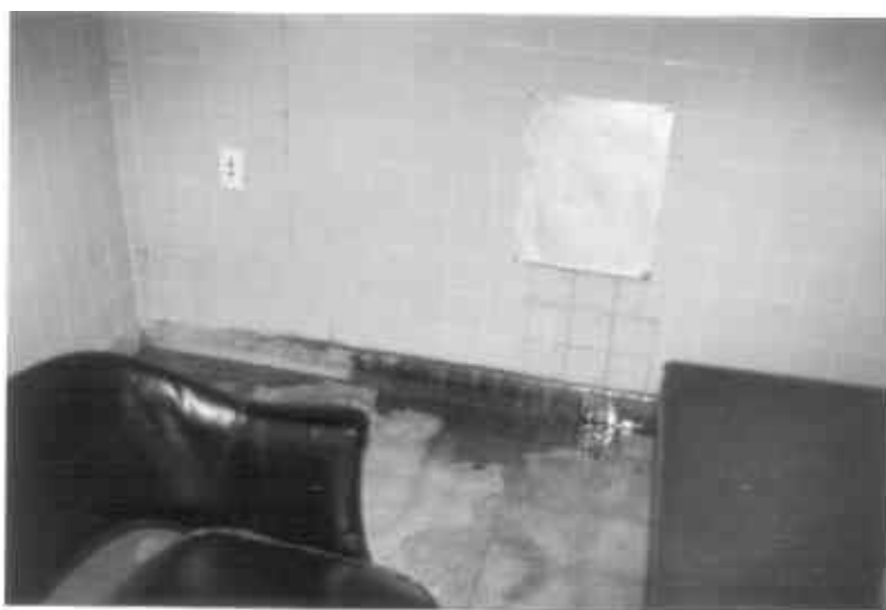
Hospital Dr. A. Oñativia. FO 2 Presencia de líquido a nivel zócalo en sala de tablero general de elec- tricidad.
