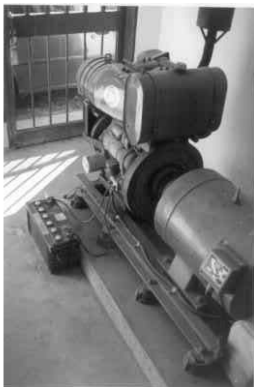
Hospital Dr. A. Oñativia. FO 6 Falta de mantenimiento de tipo predictivo. Se verifica la existencia de una sola batería.
