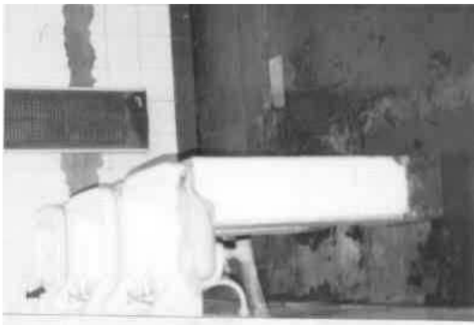
Colonia Dr. Nicolás Lozano. FCL 2. Pisos y revestimientos baño de mujeres: falta de mantenimiento correctivo. No existe matafuego a la vista.
