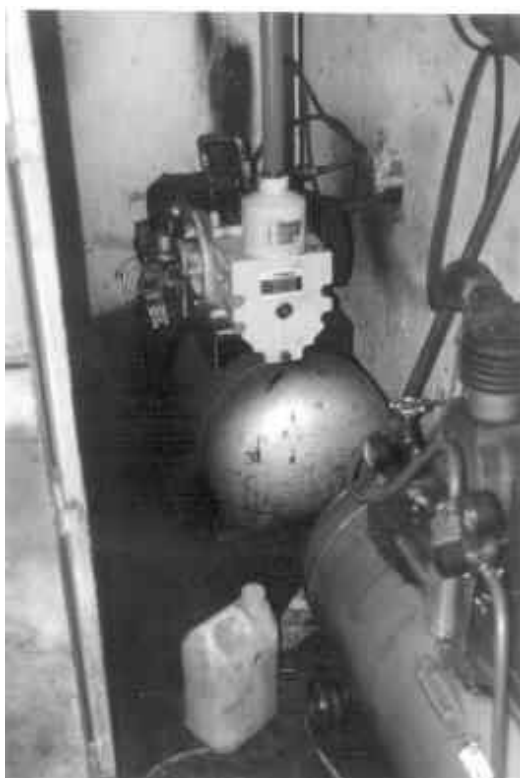
Hospital Dr. A. Oñativia. FO 7 Motocompresor y equipo de vacío. Falta de mantenimiento de tipo preventivo.
