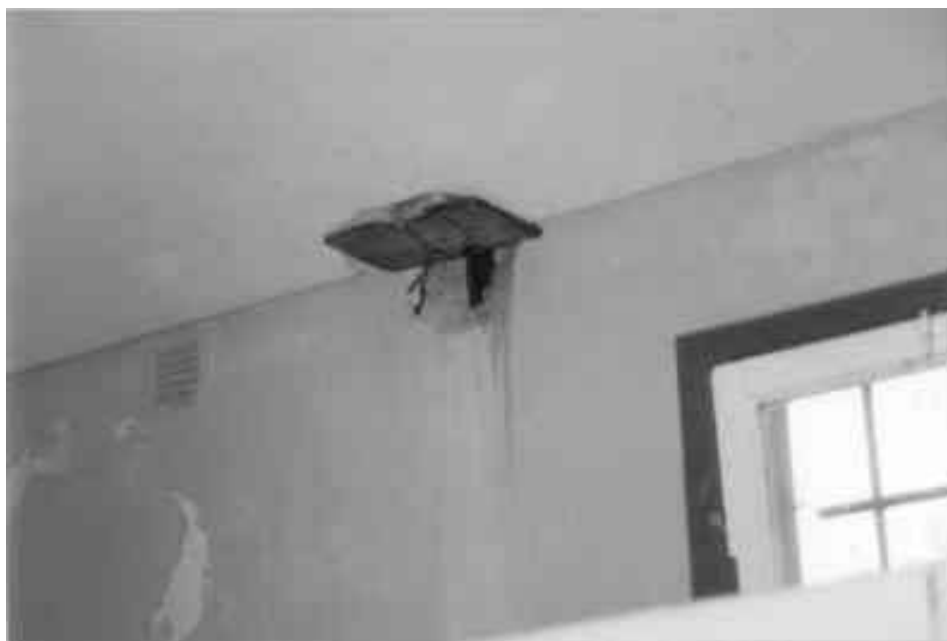
Hospital Dr. Miguel Ragone. FR 1 Reparación a nivel de cielorraso a medias.
