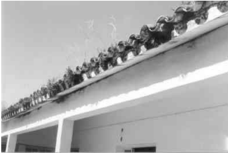
Colonia Dr. Nicolás Lozano. FCL 1. Como se verifica en la unión de fondo de losa voladizo y vigas, poniendo en riesgo la armadura de ambas estructuras
