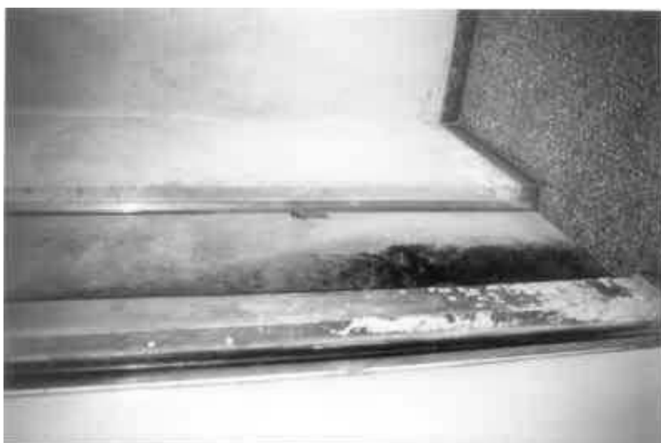
Hospital Materno Infantil. FHMI 6. Falta de mantenimiento correctivo. Vestigio de incendio en sector sanitarios para el personal planta alta.
