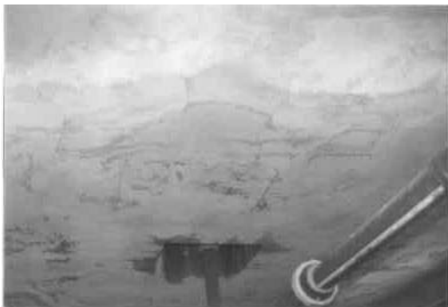
Hospital Dr. A. Oñativia. FO 3 Humedad en el fondo de losa que soporta tanques de fibra de vidrio. Falta de mantenimiento correctivo. Riesgo en la armadura de losa.
