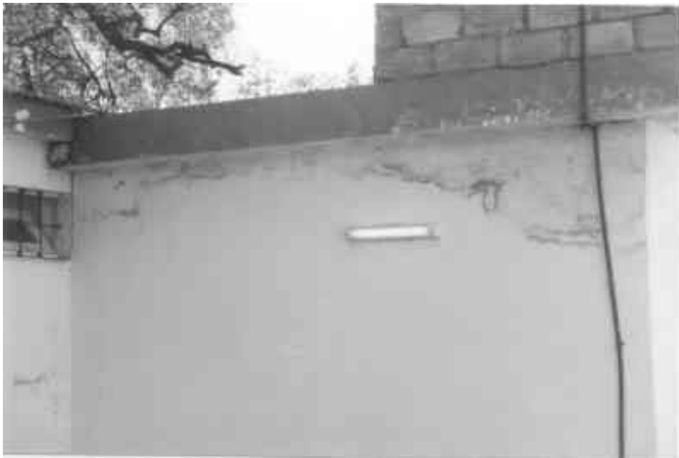
Hospital Dr. Miguel Ragone, FR 3 Humedad: sector exterior por filtración de losa.
