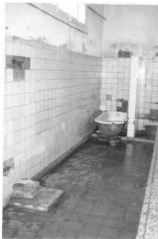
Colonia Dr. Nicolás Lo- zano. FCL 3. Sector Sanitarios. Griferías no funcionan, a excepción del que provee agua tibia a la bañera co- locada a los efectos.
