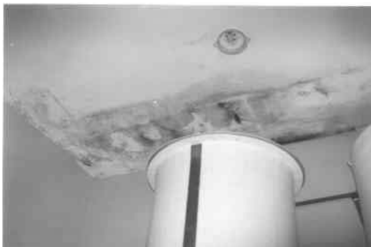
Hospital Dr. A. Oñativia. FO 5 Humedad en fondo de losa en el sector producción de agua destilada.
