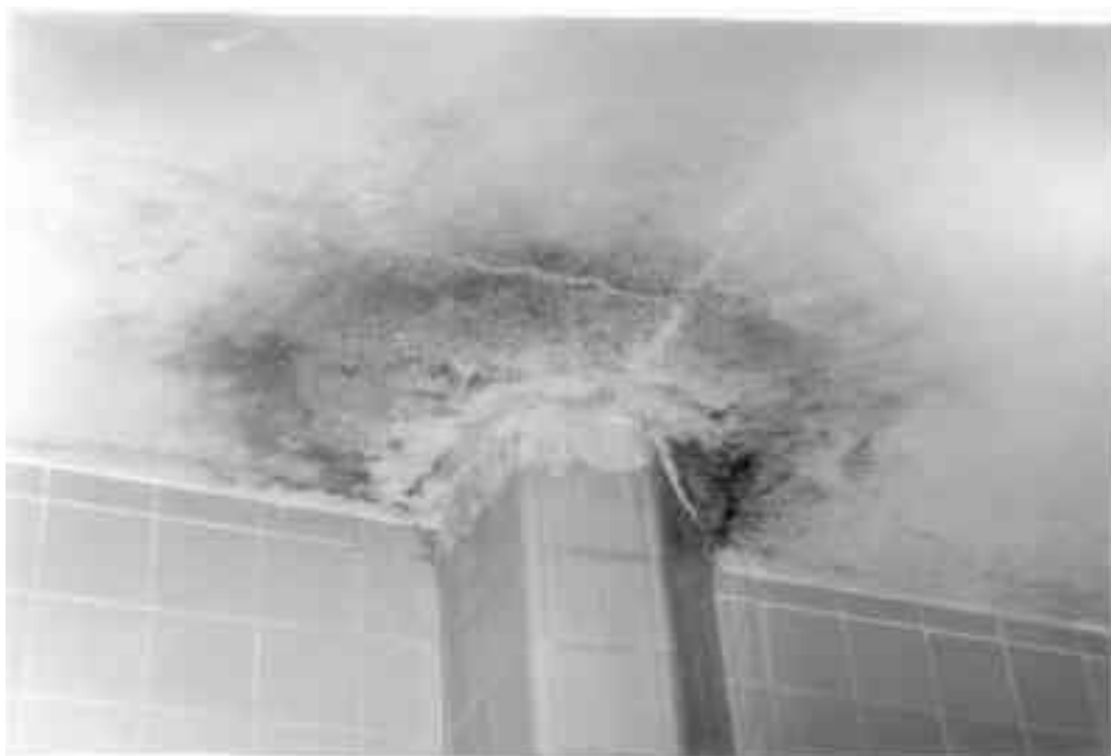
Hospital Dr. A. Oñativia. FO 4 Vestigio de humedad en losa y conducto.
